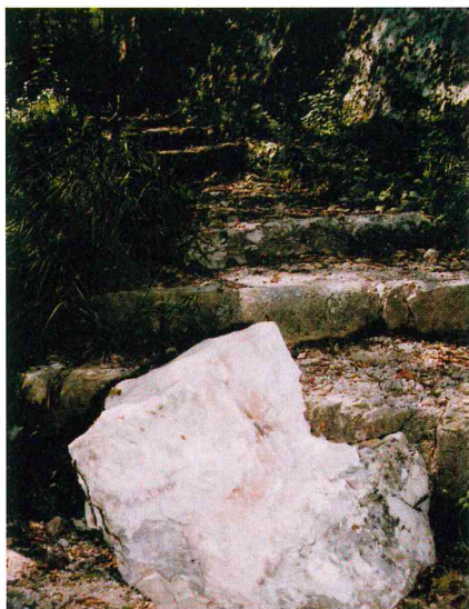
Il masso caduto sul gradini del sentiero che sale all'Eremo (foto Alfredo Martini)
